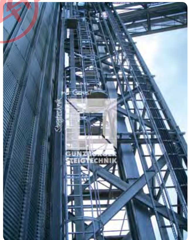
Steigleiter ■ Versetzte Ausführung ■ Mit Umsteigeplattformen
