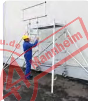
Vor dem Besteigen der ersten Plattform wird der Zusatzrahmen mühelos vom Boden aus eingesteckt.
